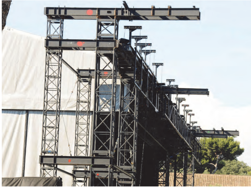
Figura 1.4 – 7 Esempio di palco realizzato con sistemi integrati - Particolare
