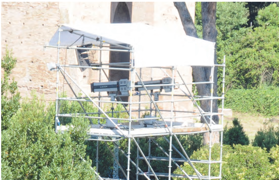
Figura 1.3 – 8 Impianto luci, particolare
