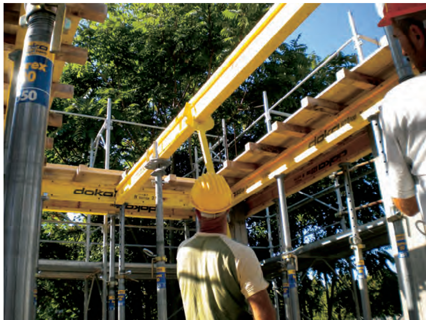
Figura 46 - Fase di montaggio dell'orditura primaria dal basso con l'uso di apposite forche
